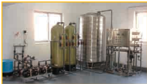
■ 設於廠區內的純水過濾系統。
