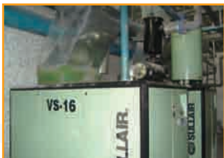
■ 中央真空泵系統，可節省電力，並減免車間內的噪聲及高溫。
