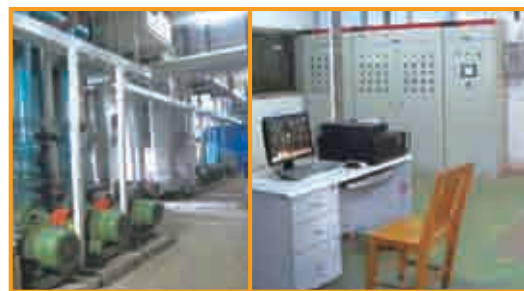
■ 冰蓄冷空調機組。
