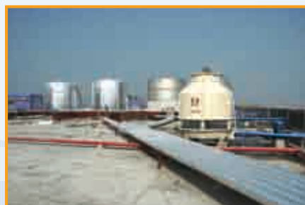
■ 餘熱回收管保溫儲水罐。
