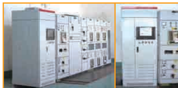
■ 電力監控機組。
