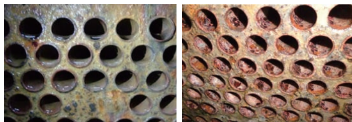
■ 安裝前，冷凝器佈滿水垢。安裝後，75% 硬水清除。
