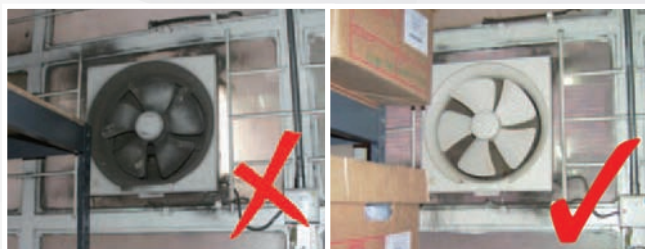
■ 佈滿塵埃的機械通風設備（清理前）。
